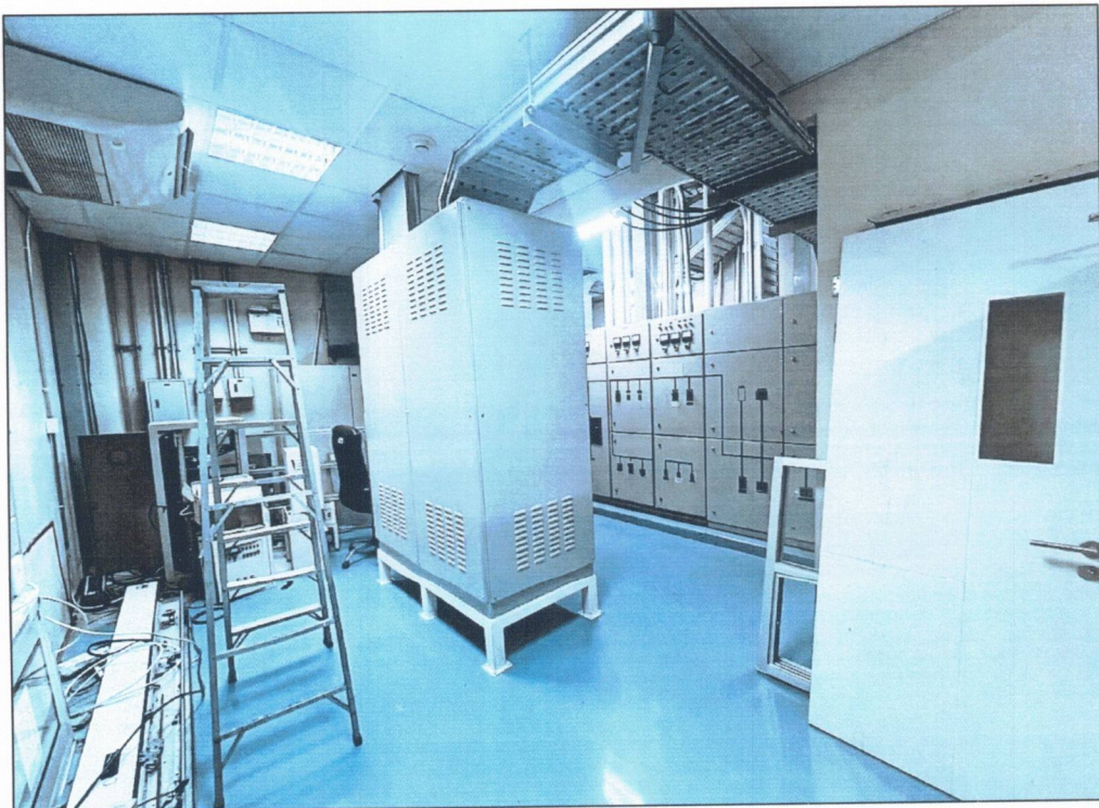
ห้องไฟฟ้า
