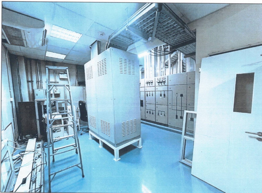
ห้องไฟฟ้า
