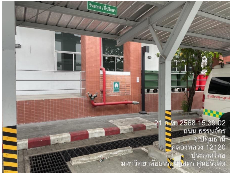
ภาพที่ 30 หัวรับน้ำดับเพลิงบริเวณจุดจอตระกูลฉุกเฉิน
