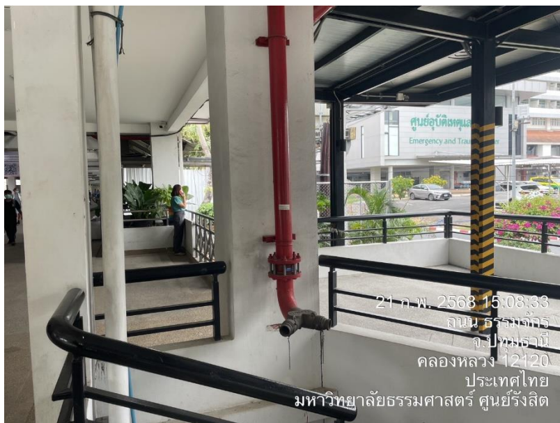
ภาพที่ 39 หัวรับน้ำดับเพลิงบริเวณทางเดินตรงข้ามอาคารไทยพาณิชย์
