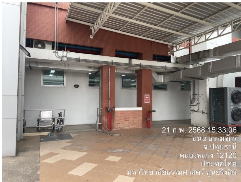
ภาพที่ 31 หัวรับน้ำดับเพลิงบริเวณด้านข้างงานอุบัติเหตุและฉุกเฉิน
