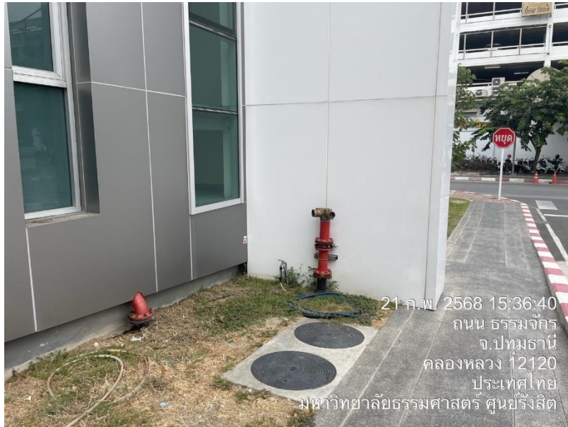
ภาพที่ 38 หัวรับน้ำดับเพลิงบริเวณด้านขวาของอาคารชวนชูชาติ วพ.7
