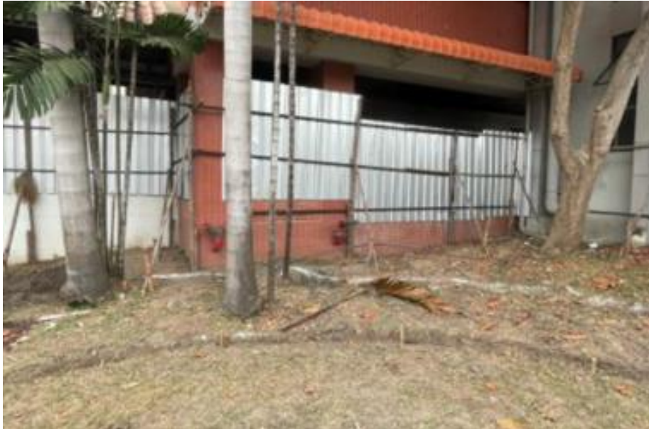
ภาพที่ 32 หักรับน้ำดับเพลิงบริเวณด้านหน้างานอุบัติเหตุและฉุกเฉิน
