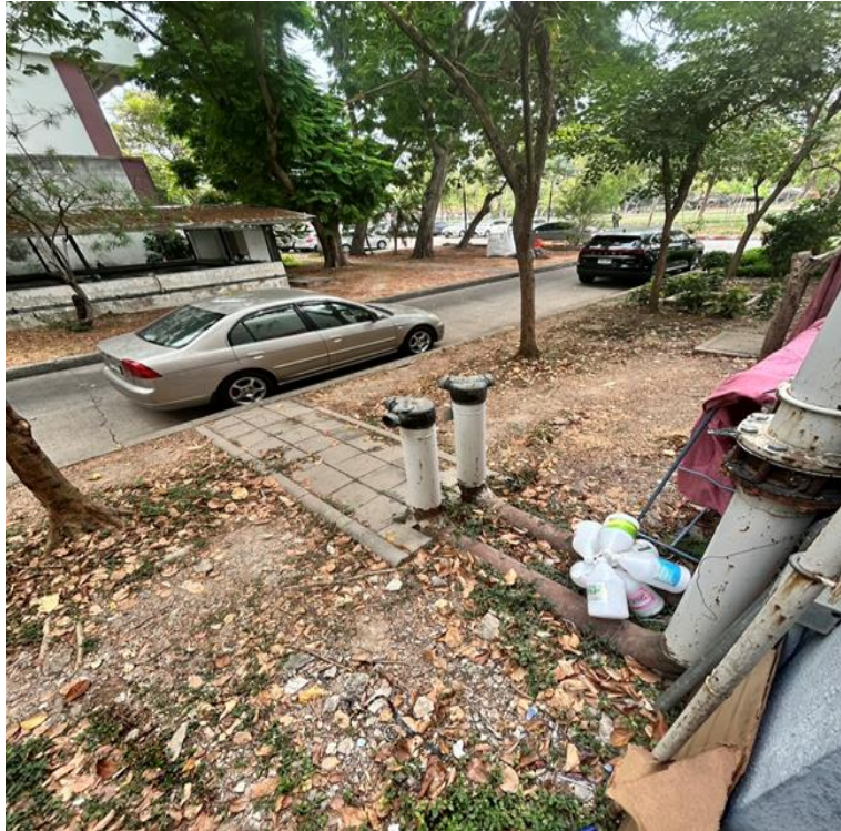
ภาพที่ 34 หัวรับน้ำดับเพลิงบริเวณด้านข้างอาคารหอพักบุคลากรโรงพยาบาล
