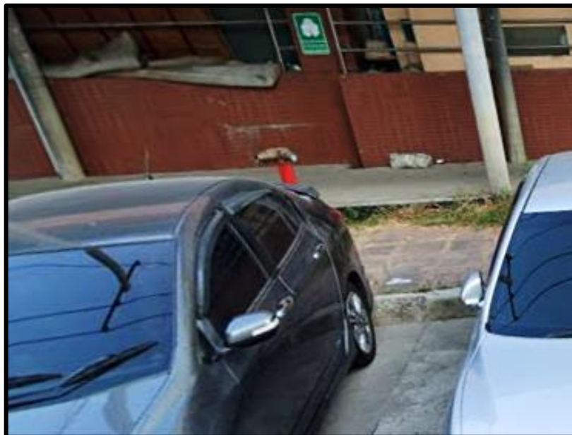
ภาพที่ 35 หัวรับน้ำดับเพลิงบริเวณจุดจอดรถด้านหลังอาคารบริการ
