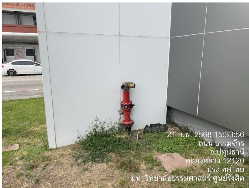
ภาพที่ 37 หัวรับน้ำดับเพลิงบริเวณด้านซ้ายของอาคารชวนชูชาติ วพ.7
