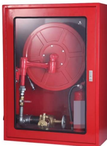
ภาพที่ 24 Fire Hose
